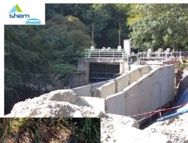
Prise d'eau de l'UHE d'Olette sur la Têt Thuès
