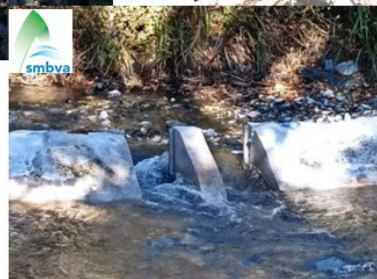
Arasement ou aménagement de 3 ouvrages de prise d'eau sur la Boulzane à St Paul de F.
