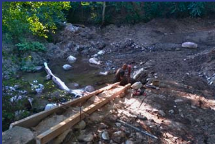
Vue des filtres anti matières en suspension et reprise de maçonnerie
